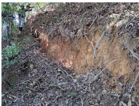
令和5年7月の地滑り調査の様子
