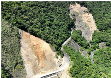
地滑り調査中の村道湯湾大堀線 （撮影：2024/7/5）
