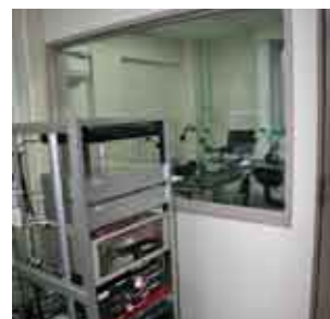
湯湾の郵便局裏にある建物へ整備された放送施設
