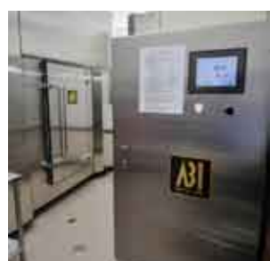
「結いの館」の建物内へ整備されたCAS冷凍機
