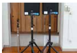
音響・放送設備
